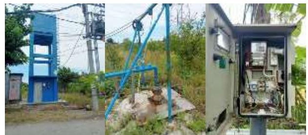
Gambar 1. Sumur, tandon dan panel listrik bantuan dari pemerintah
