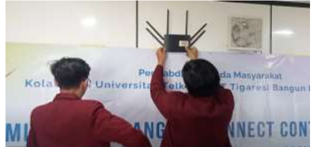
Gambar 7 Instalasi Jaringan di container kantor
