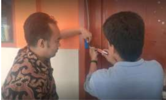
Gambar 2. Workshop dan implementasi sistem akses control berbasis RFID
