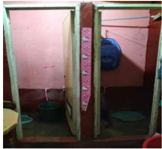
Toilet sekolah (sebelum perbaikan)
