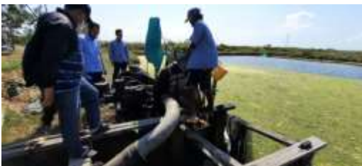
Gambar 6. Pompa diesel di lokasi Mitra
